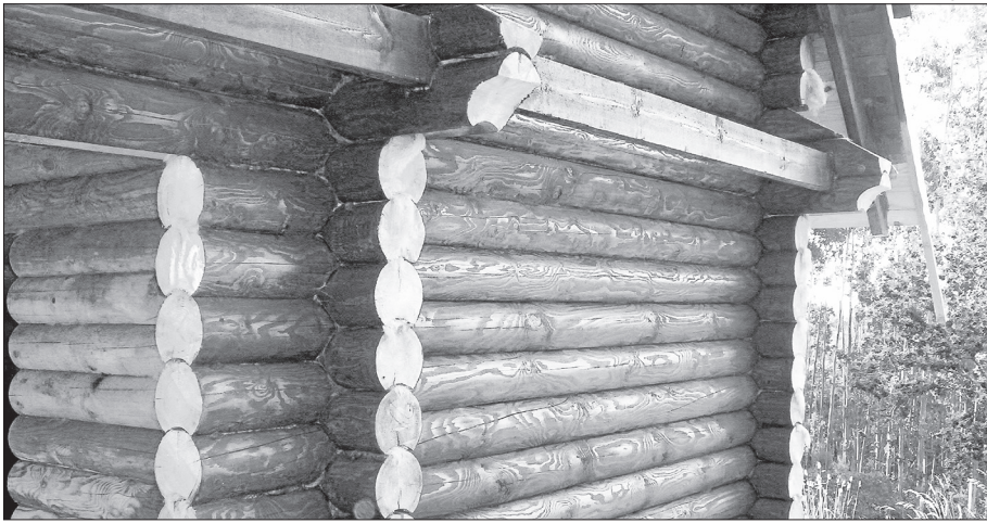
Baño ruso en construcción a partir de troncos de pino rojo de 18 centímetros
